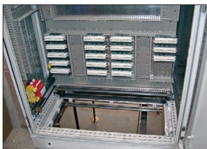
Bild 7: Doppelboden unter Rangierverteiler – Anschlussleitung für den Potentialausgleich ist kürzer als 50cm
