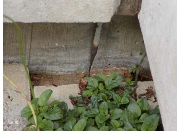
Bild 2 Durchgerostete Erdereinführung ohne Korrosionsschutz
