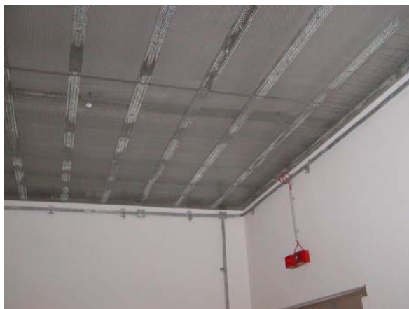
Bild 9: Nachträglich geschirmter Raum
