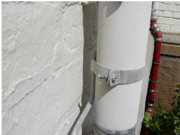
Bild 3: Nicht fachgerechter Regenfallrohranschluss
