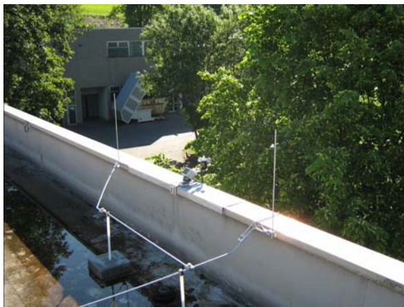
Bild 5: Geschütztes Windmessgerät an einer PVC-Außenkante
